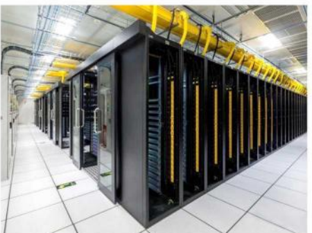
数据中心 DATA CENTER
